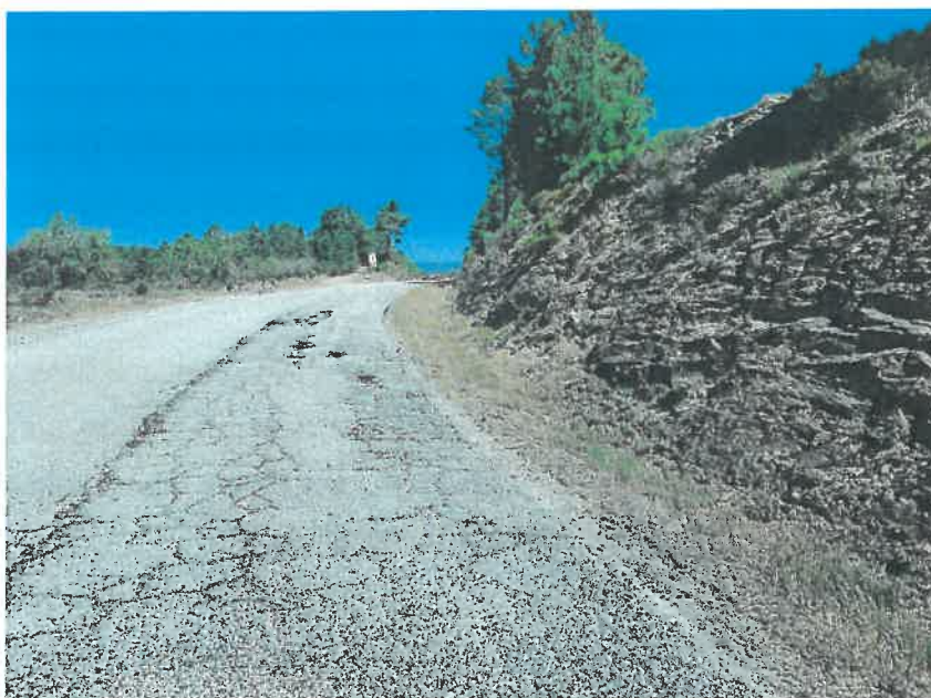
Figura 3 – Fendilhamento tipo pele de crocodilo com alguma severidade e com arrancamentos.
