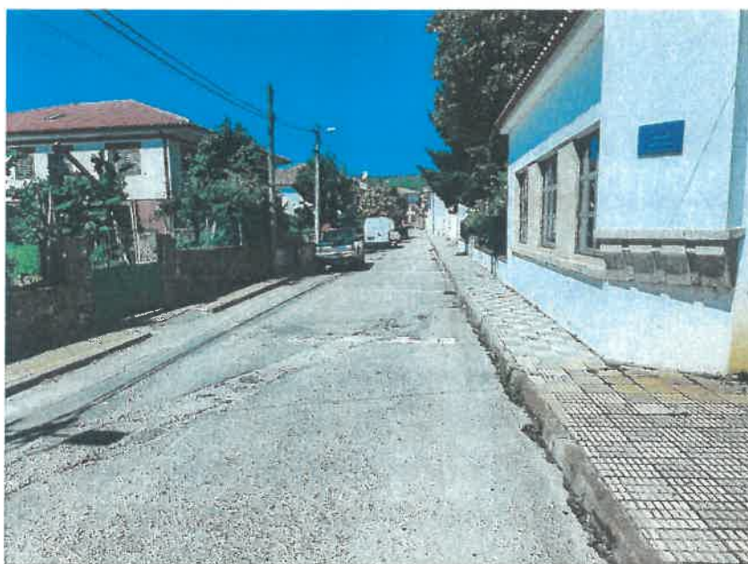
Figura 19 – Parte inicial da rua com passeios laterais. Pavimento degradado.
