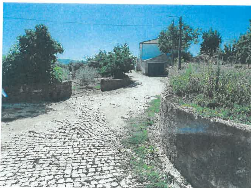
Figura 27 – Ausência de atravessamento de águas pluviais.
