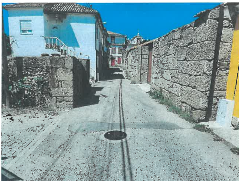
Figura 20 – Parte final da rua confinada entre habitações. Pavimento degradado.
