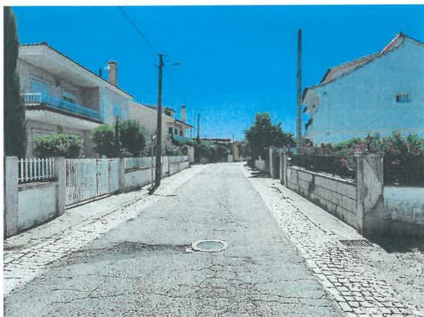
Figura 15 – Fendilhamento ramificado no atravessamento de Noura. Bermas em cubos de granito
