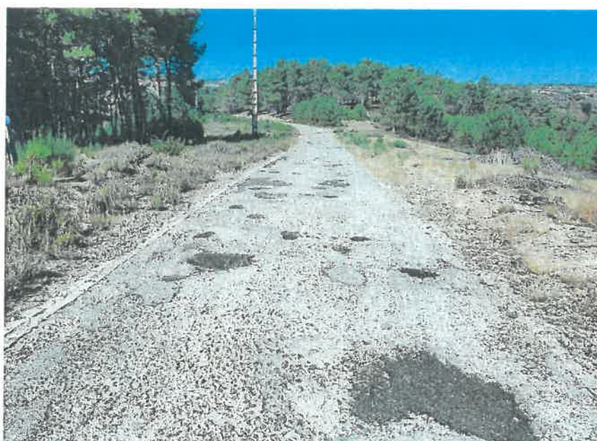
Figura 11– Pavimento em mau estado de conservação.
