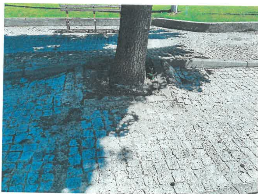
Figura 9 – Exemplos de degradação do pavimento dos passeios.
