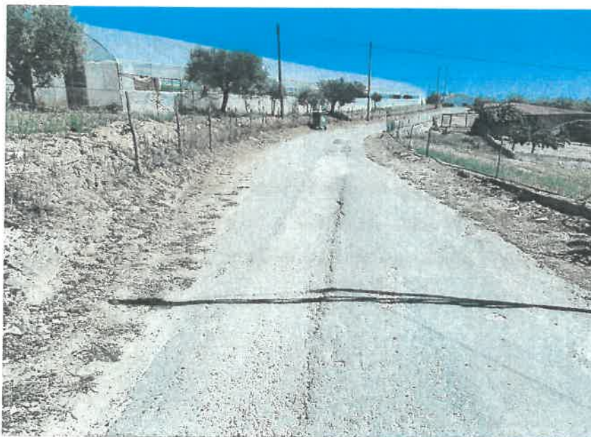
Figura 24 – Degradação do pavimento existente (valas).
