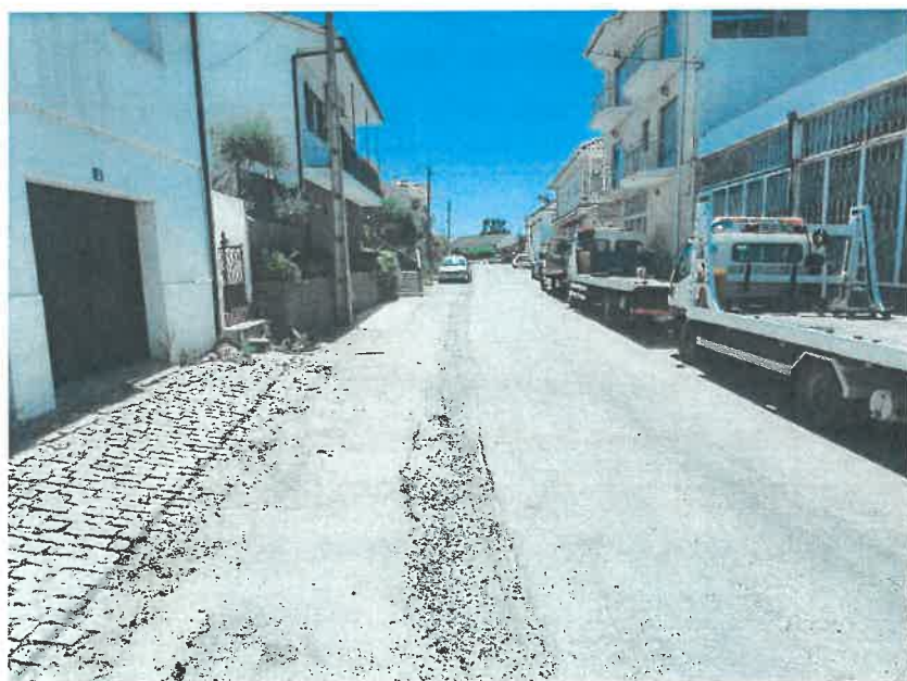
Figura 18 – Exemplo da degradação verificada.
