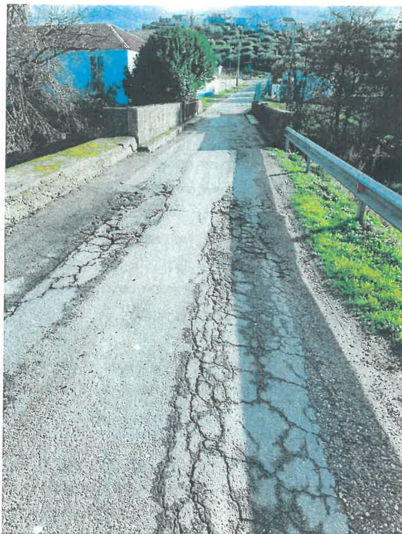
Figura 35 – Pavimento muito degradado.
