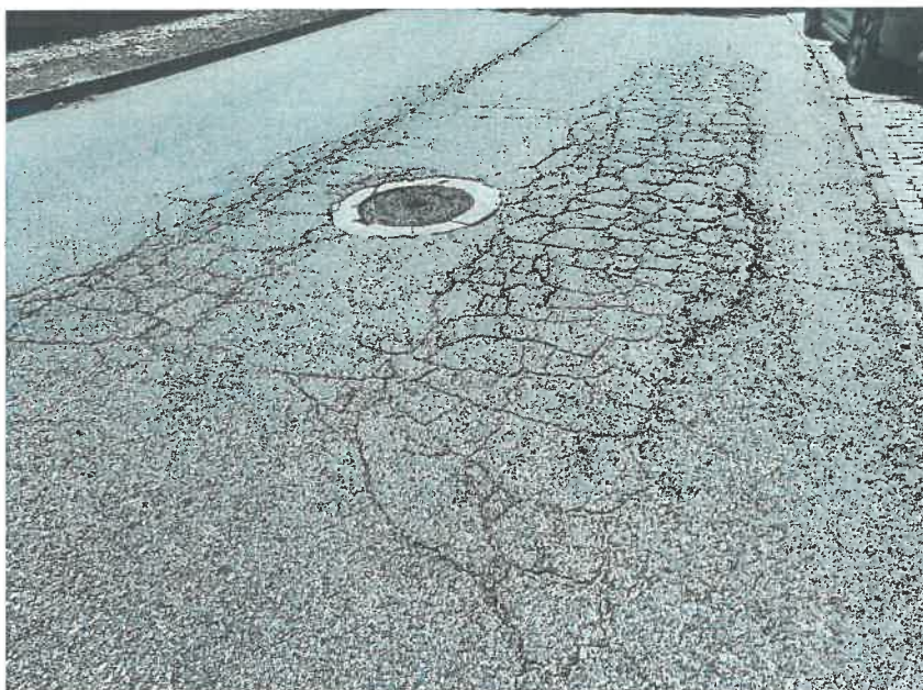
Figura 7 – Fendilhamento tipo pele de crocodilo com elevada severidade (atravessamento de Murça).
