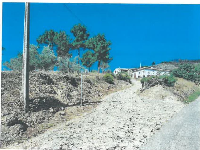
Figura 29 – Rachão com irregularidades transversal e longitudinal.
