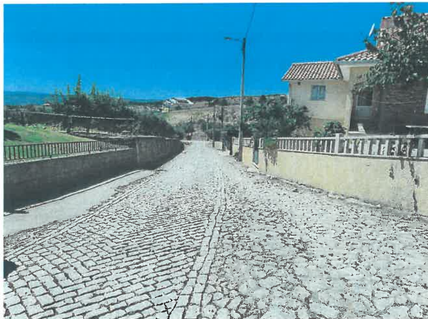
Figura 25 – Paralelepípedes de granito com irregularidades (transversal e longitudinal).
