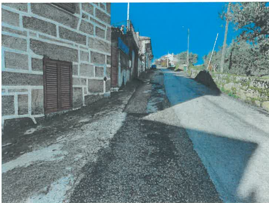
Figura 34 – Vala mal executada.
