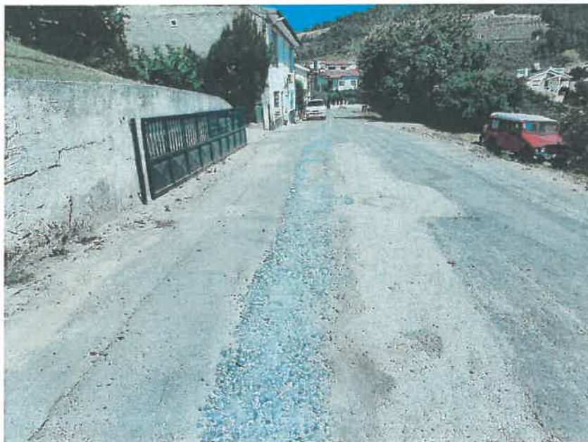
Figura 17 – Exemplo da degradação verificada.
