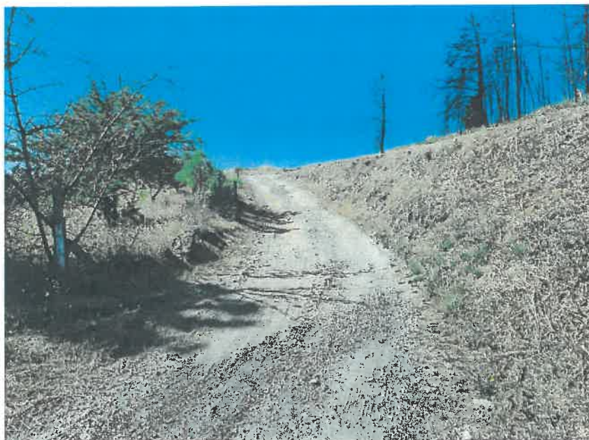
Figura 30 – Troço não pavimentado. Ausencia de drenagem transversal.
