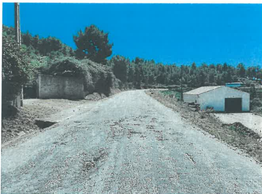
Figura 12 – Pavimento em mau estado de conservação.
