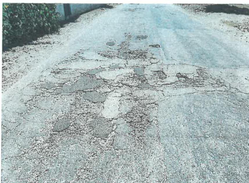
Figura 13 – Remendos mal executados.
