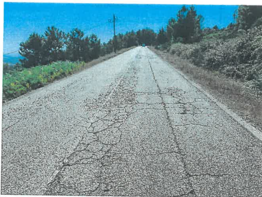
Figura 2 – Fendilhamento tipo pele de crocodilo e fenda longitudinal.
