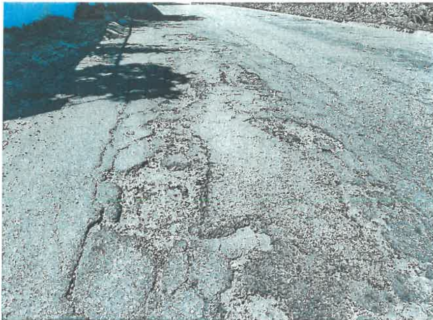
Figura 16 – Degradação do pavimento com arrancamentos.
