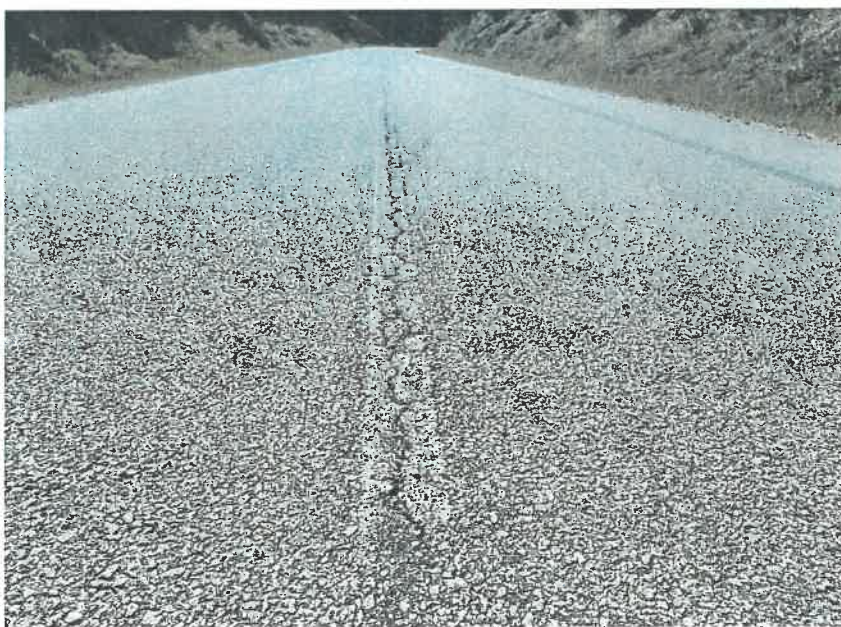
Figura 4– Fendilhamento longitudinal em processo de ramificação no eixo da via.
