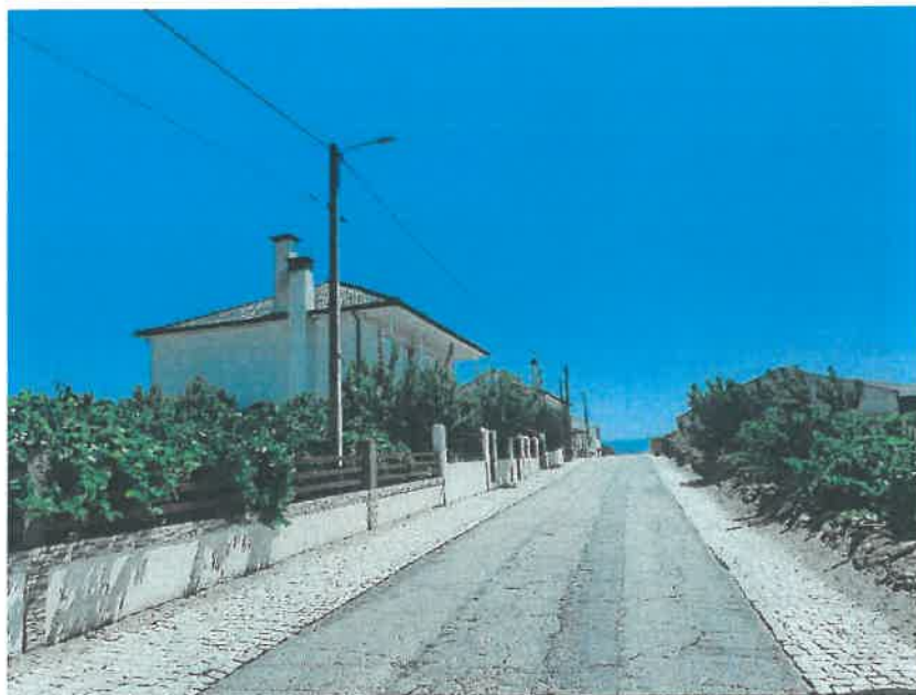
Figura 14 – Fendilhamento ramificado no atravessamento de Noura. Bermas em cubos de granito
