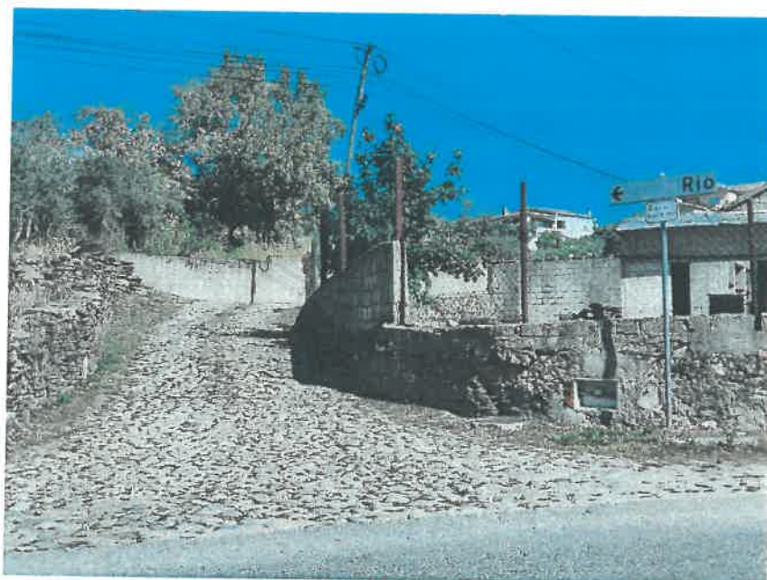
Figura 26 – Rachão com irregularidades (transversal e longitudinal).
